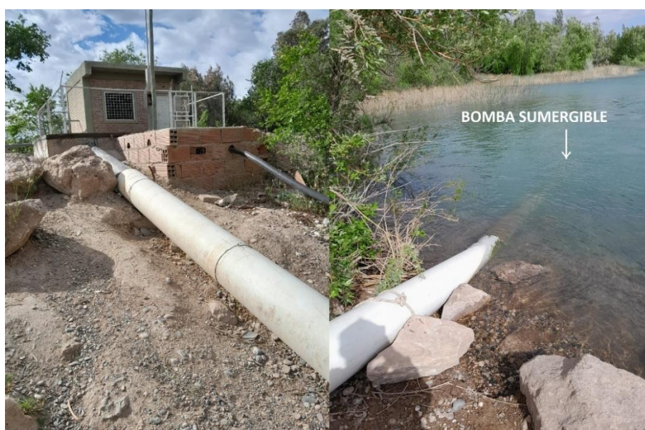
Figura 16. Captación de agua ARSA desde el Río Limay.
