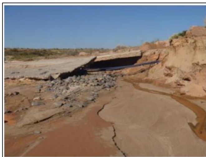
Figura 16. Línea de conducción con defensa aluvional mal diseñada dentro de cauce (Fuente: coirco.gov.ar)
