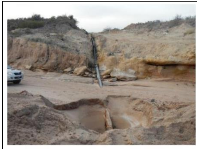
Figura 15. Línea de conducción sin defensa aluvional dentro de cauce (Fuente: coirco.gov.ar).
