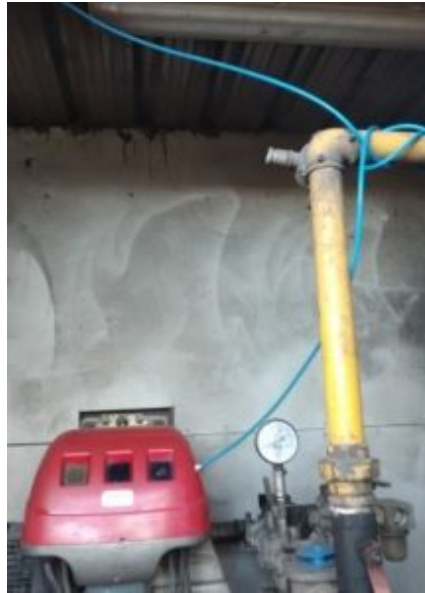
Figura 26. Rediseño sistema de enfriamiento módulo de control quemador Riello.
