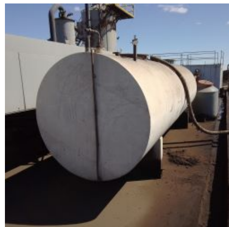
(d) Tanque de reserva.
