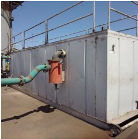
(a) Tanque separador.
