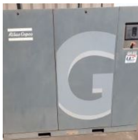
(b) Compresor a tornillo.
