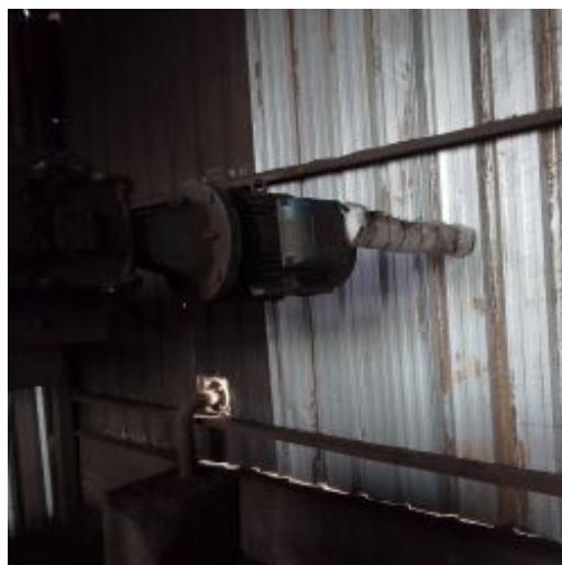
Figura 29. Aislación térmica cableado motor eléctrico tornillo by-pass .
