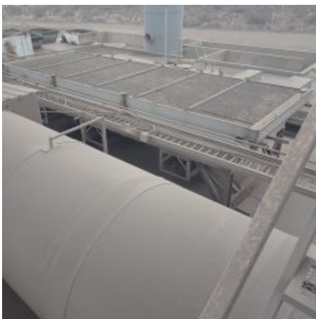
(c) Aeroenfriador del quench scrubber .
