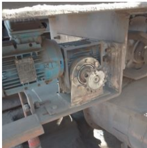
Figura 28. Detalle motoreductor de backup .
