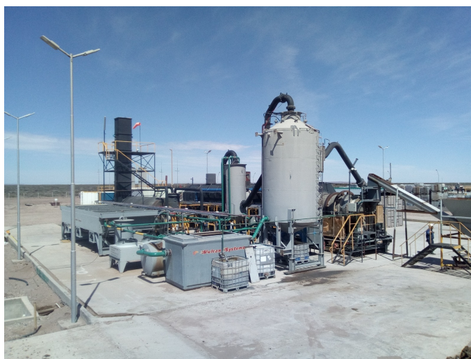
Figura 4. Horno instalado en la base de la Empresa.
