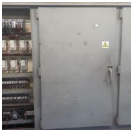
(a) Tableros eléctricos.
