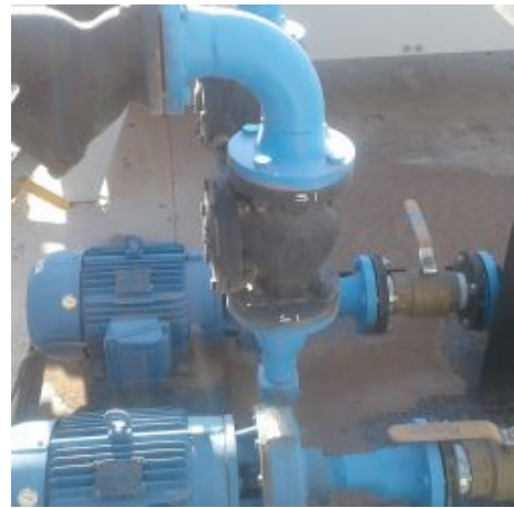
(b) Sistema de bombas.
