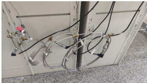
Figura 3.14: cables conectores de sensor-display.
