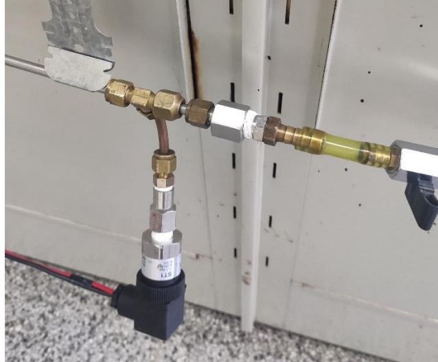
Figura 3.9: entrada al circuito en la parte de la tubería recta.
