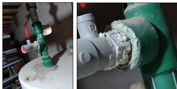
Figura 48. Cristales de sal en termotanque eléctrico
