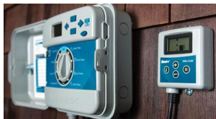
Ilustración 52. Computadora de riego con su interfaz al sensor de humedad
