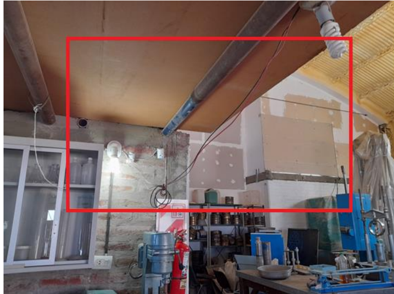
Figura 28: Problemas de Orden y Limpieza en las instalaciones del Laboratorio de Ingeniería Civil
