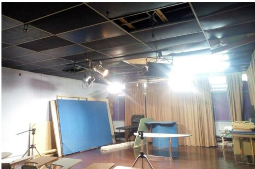
Un set de televisión en estado muy precario.
