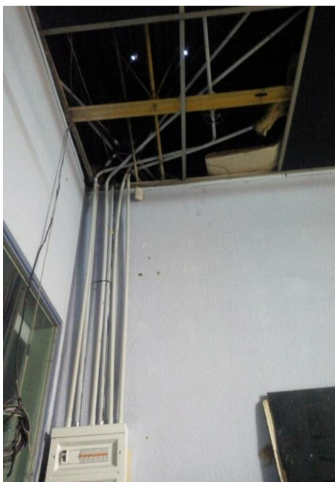
Techos en mal estado que no atajan la lluvia. Sistemas de cableado expuestos a la humedad.
