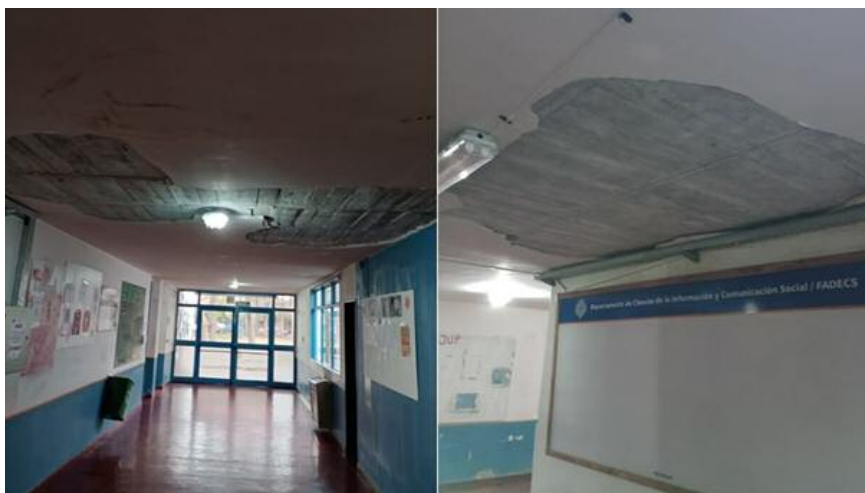
Mampostería que se desprende de los techos.
