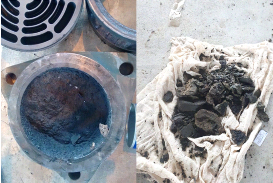
Figura 32. Partículas sólidas encontradas en el interior de los cilindros del compresor.
