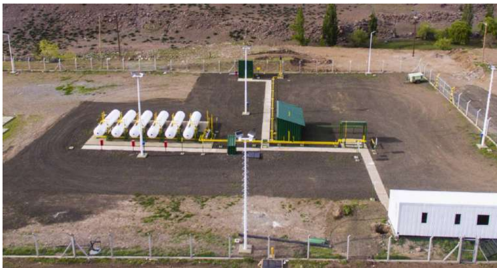
Figura 2. Planta de almacenamiento y distribución de GLP en la localidad de Los Miches, provincia de Neuquén ( https://www.hidenesa.com.ar/ ).
