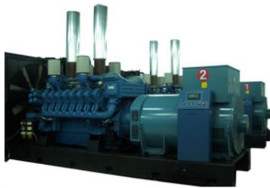
Figura 22 Generador de MT a Diesel
