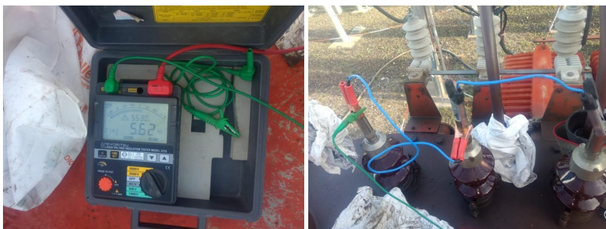
Figura N°07: Medición de Resistencia de aislamiento del TP
