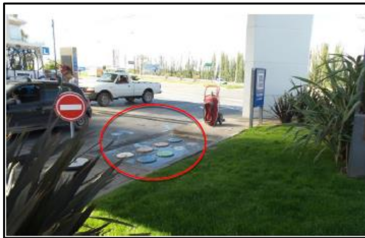
Figura 29. Bocas de recarga de tanques diferenciadas por color.
