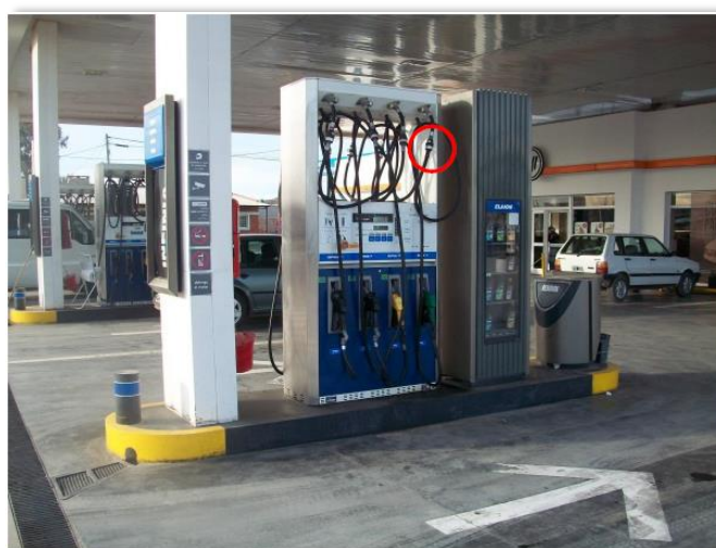
Figura 3. Ubicación de la válvula break away
