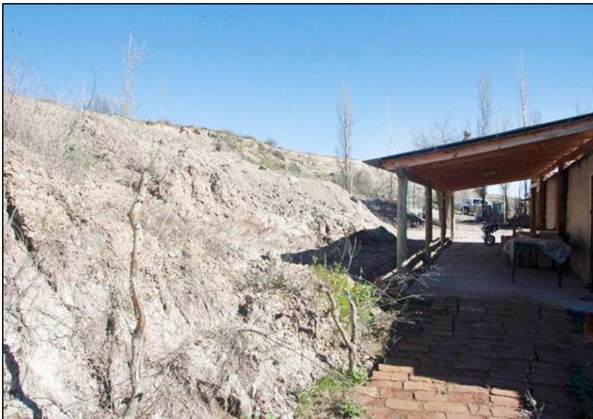
Figura 37: Vivienda afectada por coladas de barro producto de los deslizamientos rotacionales (Fuente Diario La Mañana de Neuquén ) 9 .
