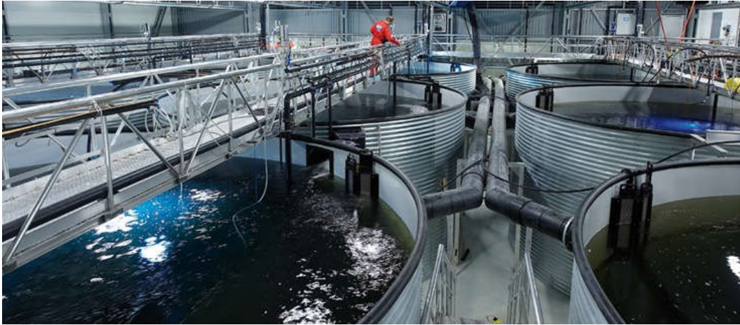
Figura 5.3. Parte de un sistema de recirculación en instalaciones bajo techo con tanques de metal, sistema de tuberías, pasarelas, etc.
